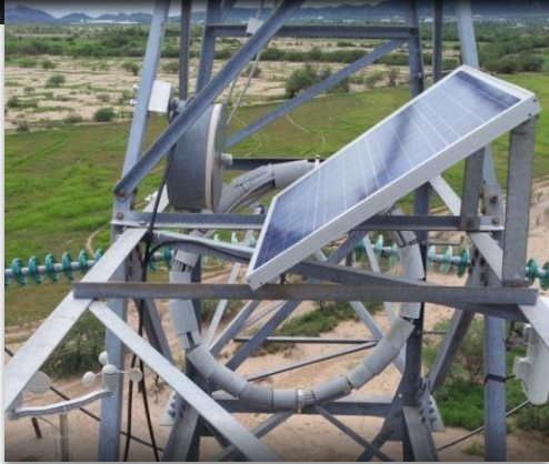
Monitoreo de líneas aéreas y subterráneas
